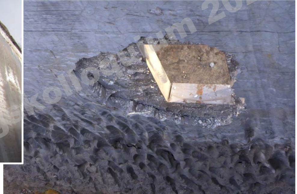
Abb. 2: Kessel nach 18 Jahren Betrieb, Restwandstärke noch ca. 40 mm
