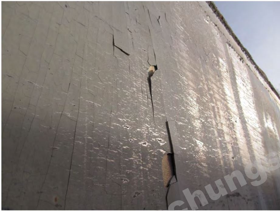
Abb. 1: Kessel nach 10 Jahren Betrieb; Die Fe-Zn-Phasen reißen während des Abkühlens aufgrund unterschiedlicher Ausdehnungskoeffizienten von Stahl und Hartzink
